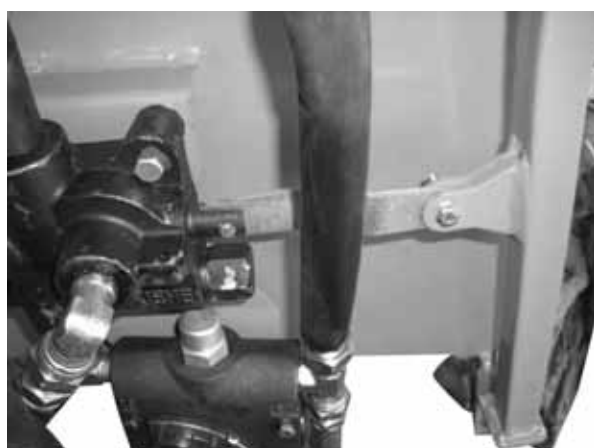
Raccordement de la vanne de commande
